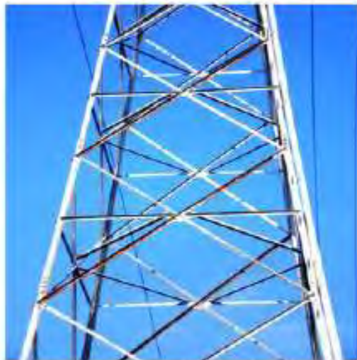
腐食鉄塔の全景
