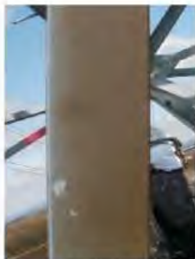
劣化度Ⅲ (メッキ層が薄くなる)
