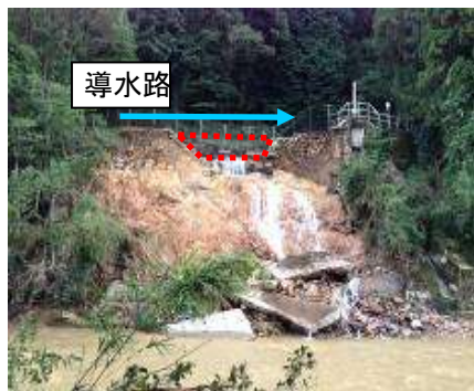
土砂崩れによる導水路損壊 (滋賀県)
