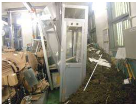
土砂崩れによる建屋損壊 (滋賀県)
