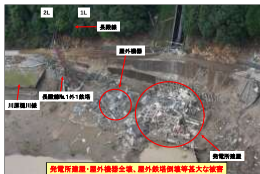
異常出水による発電所全壊 (奈良県)
