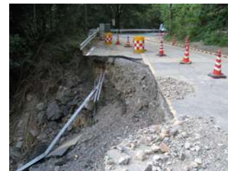
降雨による道路陥没 (京都府)
