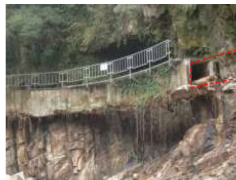
降雨による導水路崩落 (和歌山県)
