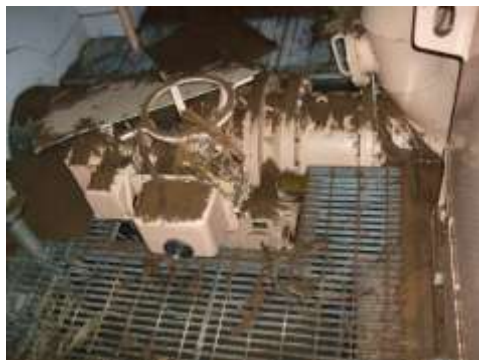
出水による発電所内浸水 (和歌山県)
