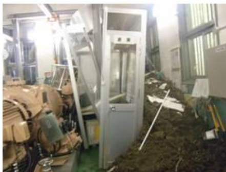
土砂崩れによる建屋損壊 (滋賀県)
