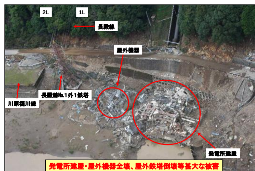
異常出水による発電所全壊 (奈良県)
