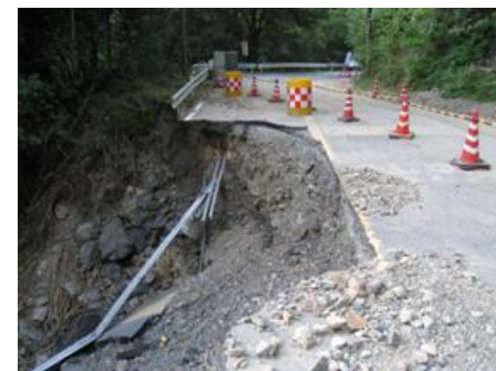
降雨による道路陥没 (京都府)
