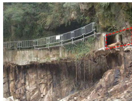
降雨による導水路崩落 (和歌山県)
