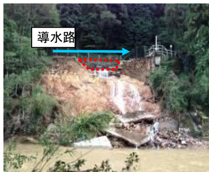
土砂崩れによる導水路損壊 (滋賀県)
