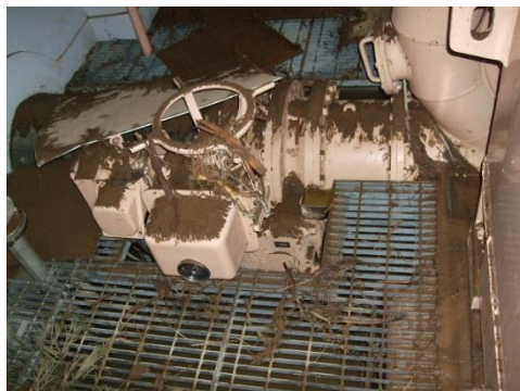
出水による発電所内浸水 (和歌山県)
