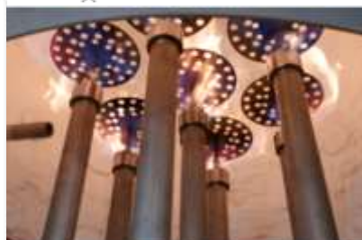
フレアスタック内部
