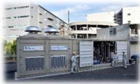
水素発生装置
