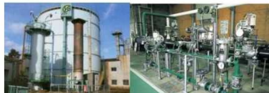
長岡中央浄化センター ガスタンク
