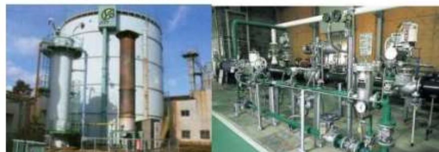
長岡中央浄化センター ガスタンク
