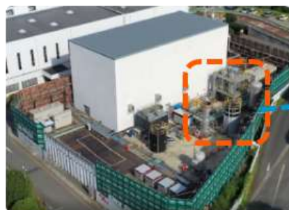
実証試験設備
