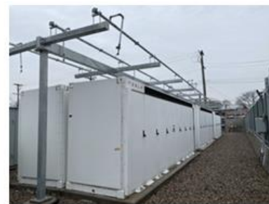
図.系統用蓄電池事業の外観 (出典：大阪ガスホームページ)
