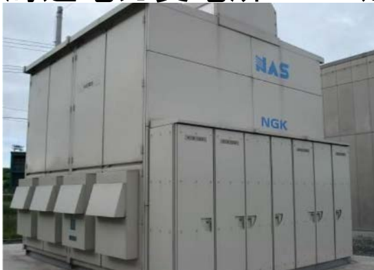
大型蓄電システム施設
