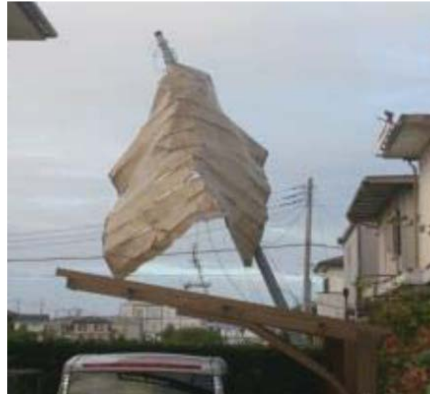
飛来物による電柱倒壊（東金市）
