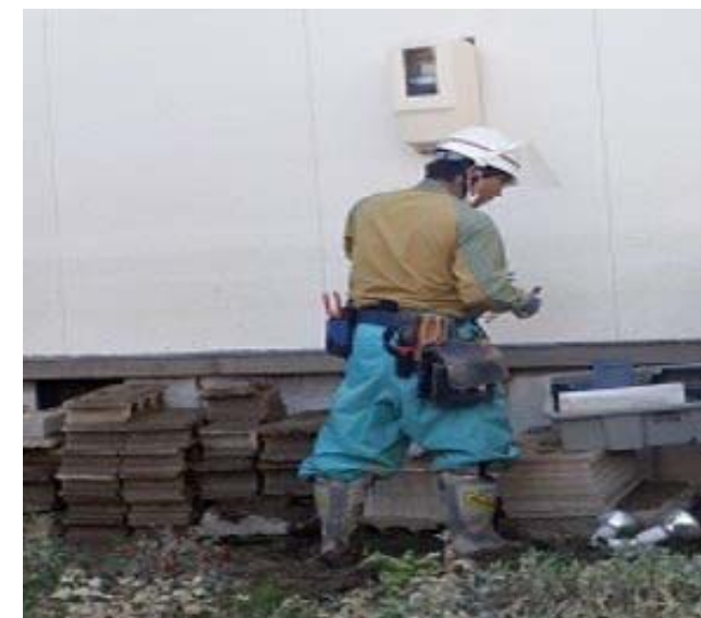
お客さま設備の絶縁抵抗測定
