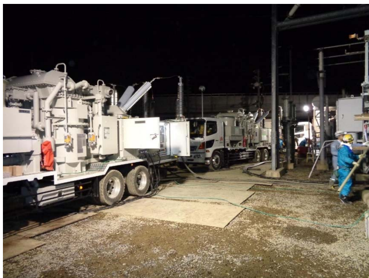
移動式変電所による対応
