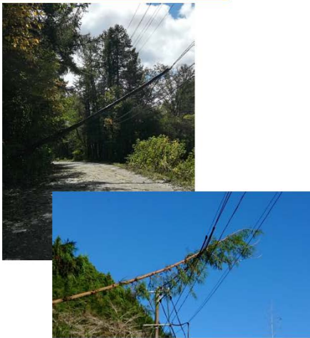
倒木現場の投稿（電線接触）
