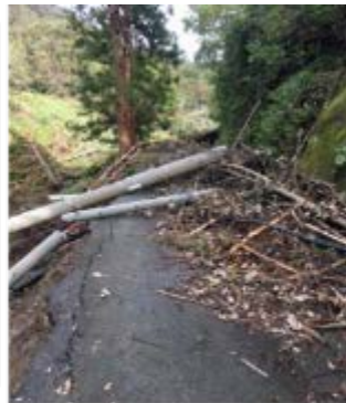
倒木に伴う電柱倒壊現場 （鋸南町）
