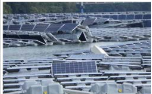
水上設置型太陽光発電所（市原市）
