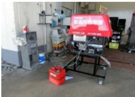
【図 32】 ガソリンスタンドの配電盤に接続された自家発電設備
