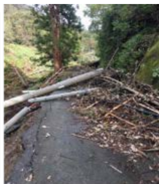
倒木に伴う電柱倒壊現場 （鋸南町）
