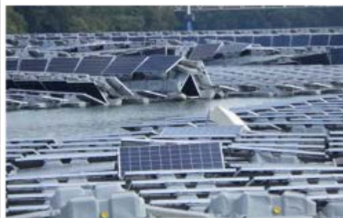
水上設置型太陽光発電所（市原市）
