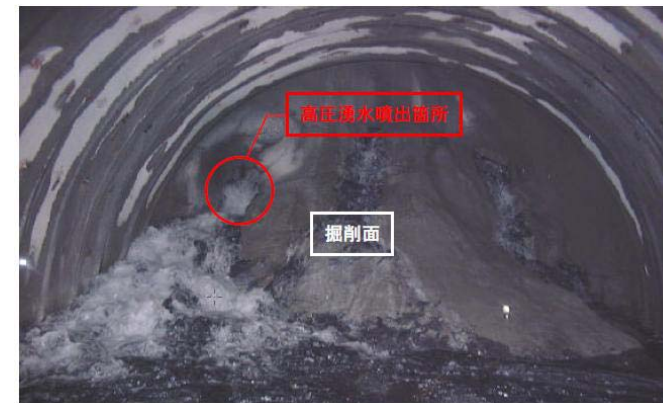
図-1 地芳トンネル突発湧水状況 1)
