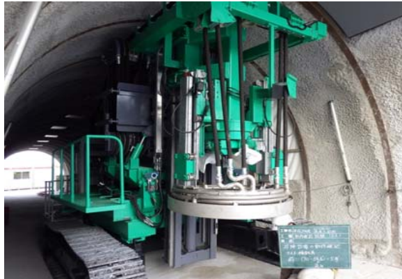
緩衝材除去装置
