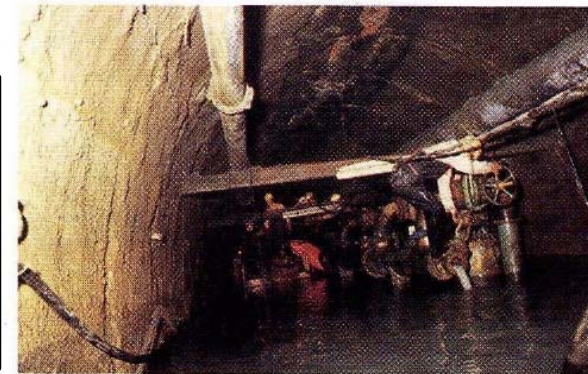
写真-8 異常出水事故 2)
