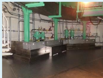
導入された コリウムシールド
