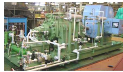
起動給水ポンプ (荏原製作所)
