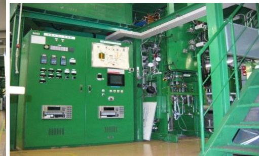
HTTR燃料製造設備
