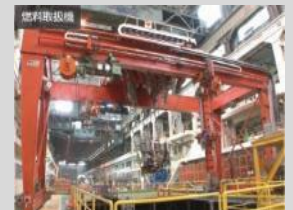
3号機向け燃料取扱設備
