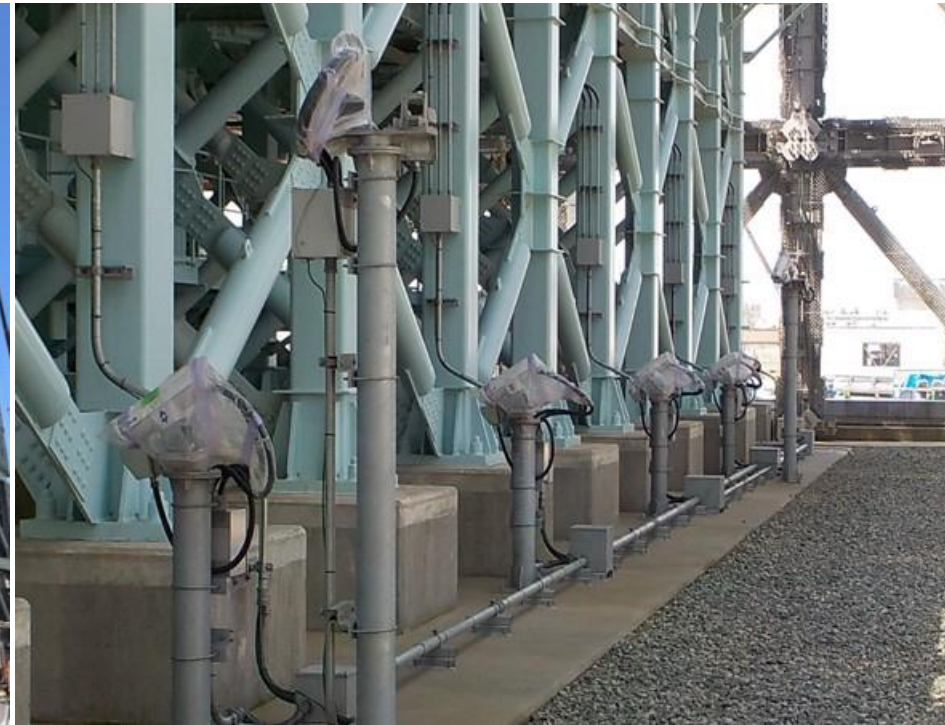
火災対策 (サーモカメラ)
