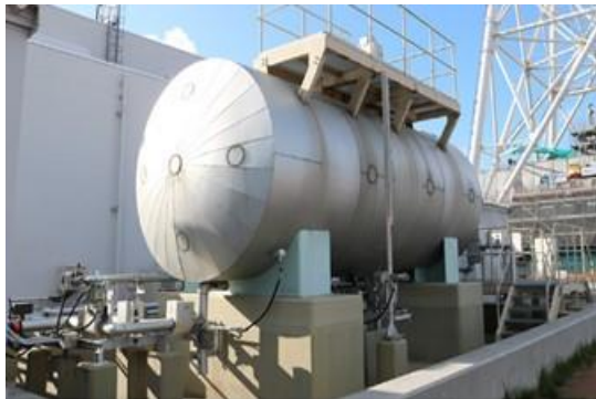
薬品貯槽 移設前
