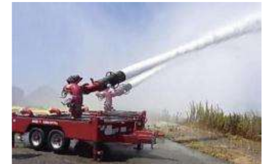
【屋外放水設備】
