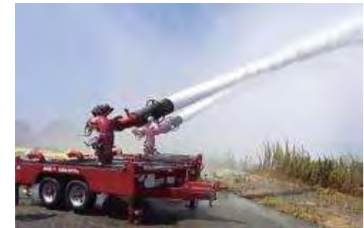
【屋外放水設備】
