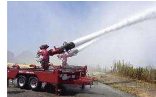
【屋外放水設備】
