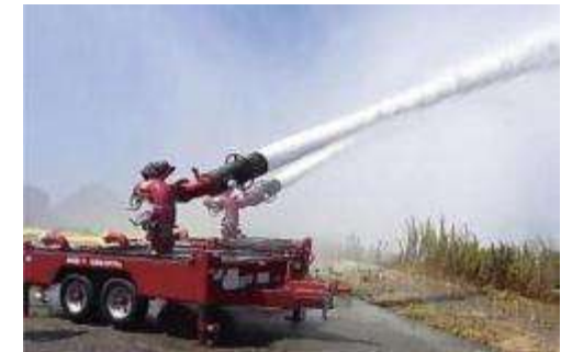
【屋外放水設備】
