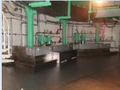
導入された コリウムシールド
