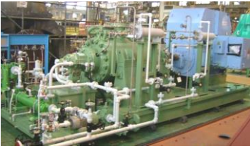
起動給水ポンプ (荏原製作所)
