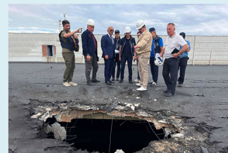
ザポリジャ原発施設の損傷状況を確認するIAEA調査団（9/1）
