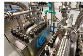
水素製造装置
