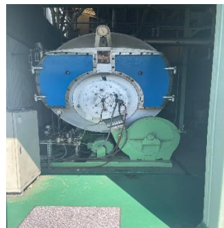
(燃転前) 炉筒煙管ボイラ
