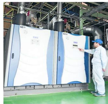
(燃転後) 貫流ボイラ
