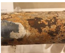
腐食した白ガス管
