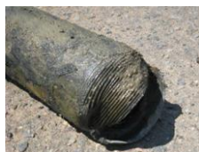
地震被害の白ガス管
