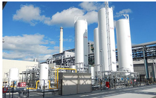
LNG貯蔵設備 丸三製紙(株) HPより
