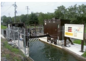
小水力発電設備 (富山県)
