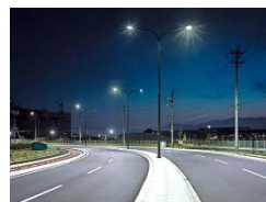
LED照明 (消費電力約56%削減)
