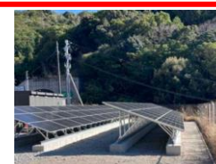
太陽光発電施設
