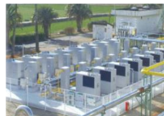
バイオガス発電
