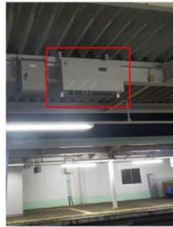
PCS (配線接続前)
