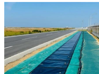
神戸空港制限区域内緑地帯 (出典:積水化学工業HP)
