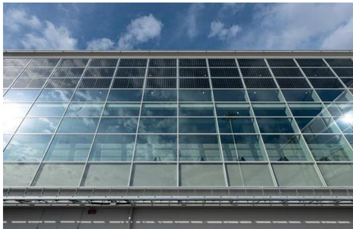
空港ビルへの設置 (ガラス一体型)
