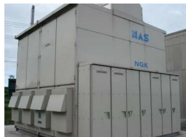
大型蓄電システム施設
