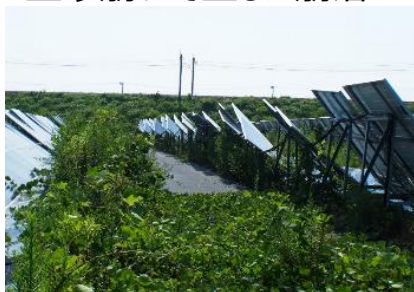
放置されたパネルの現況
