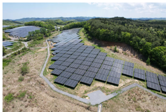
太陽光発電設備（鮫川村）
