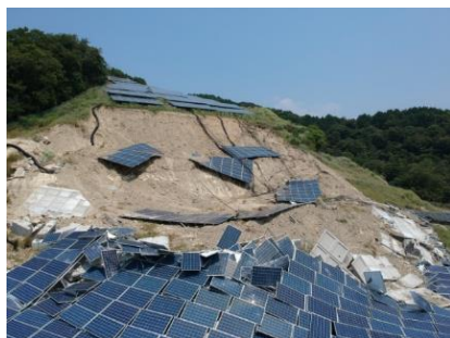
土砂崩れで生じた崩落
