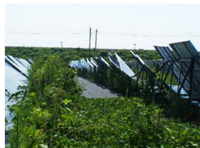
不十分な管理で放置されたパネル
