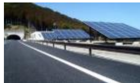
道路における太陽光発電の活用
