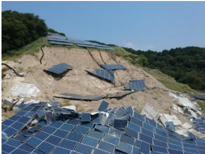
土砂崩れで生じた崩落
