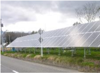
柵塀の設置されない設備
