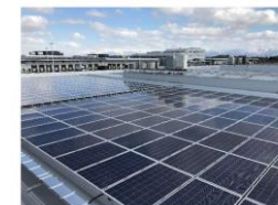
取組例：新潟市中央卸売市場に設置した太陽光パネル
