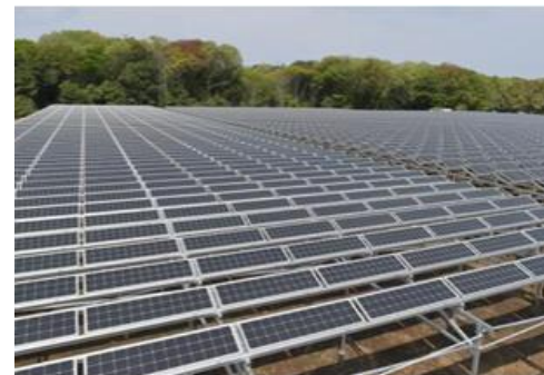
太陽光発電設備
