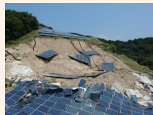
土砂崩れで生じた崩落
