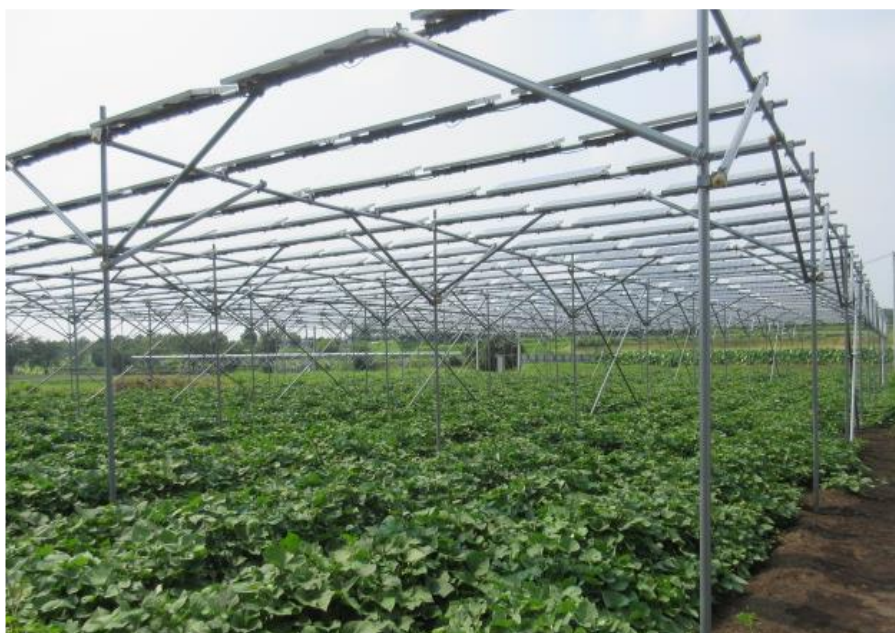
露地の畑の上部にパネルを設置
