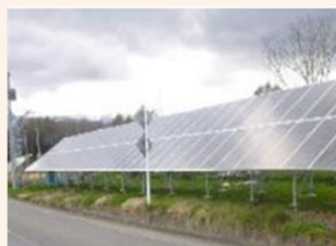
柵堀が設置されない設備
