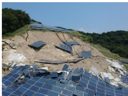
土砂崩れで生じた崩落
