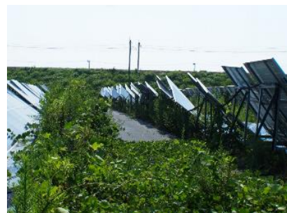
不十分な管理で放置されたパネル
