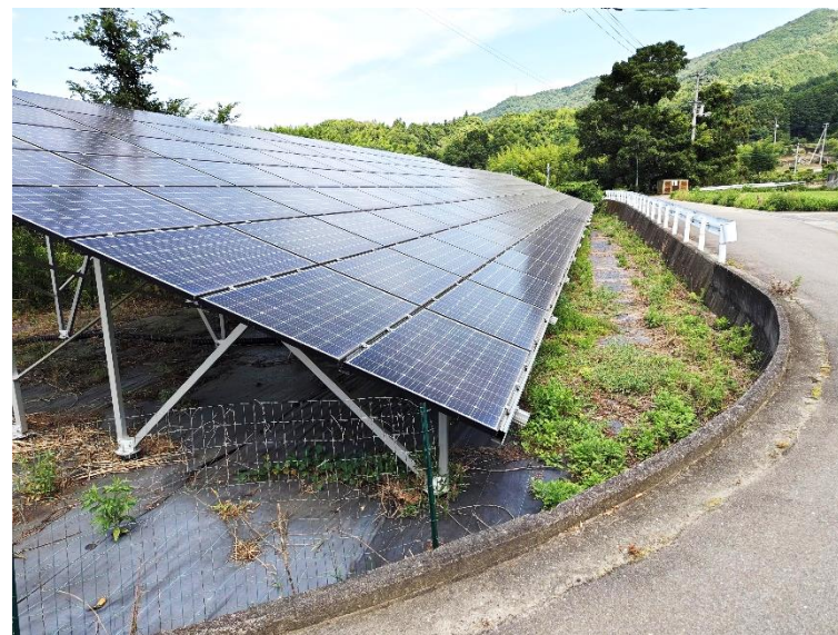
柵塀が途切れている太陽光発電設備
