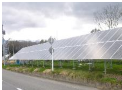
柵塀の設置されない設備
