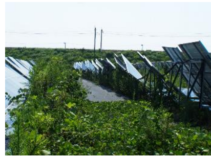
不十分な管理で放置されたパネル
