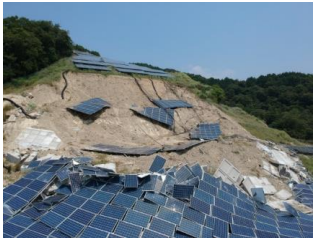
土砂崩れで生じた崩落
