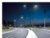
LED照明 (消費電力約56%削減)
