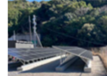
太陽光発電施設
