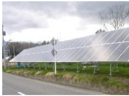
柵塀の設置されない設備
