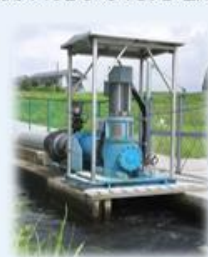
○大分県竹田市 城原井路小水力発電所
