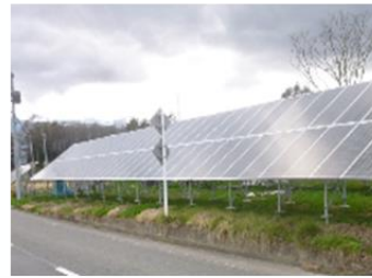
柵塀の設置されない設備
