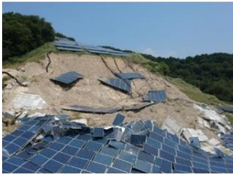
土砂崩れで生じた崩落
