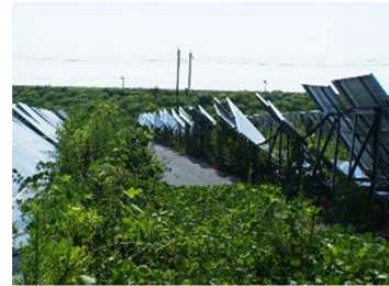
不十分な管理で放置されたパネル
