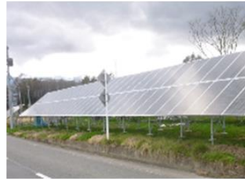
柵塀の設置されない設備
