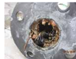
図 海水循環ポンプ冷却水配管
