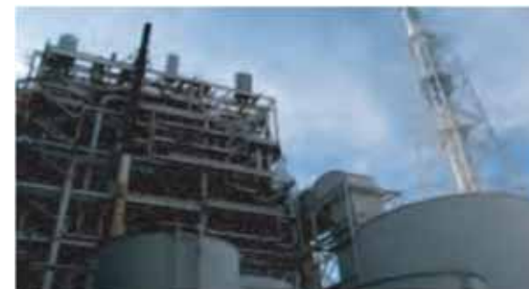
○ボイラー外観(海南発電所2号機(運転期間:43年))
