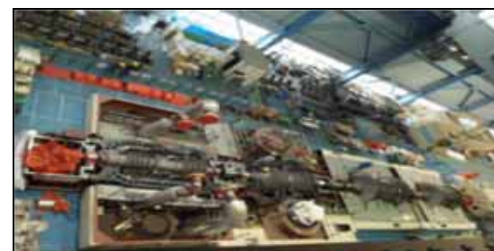
○タービン外観(海南発電所2号機(運転期間:43年))
