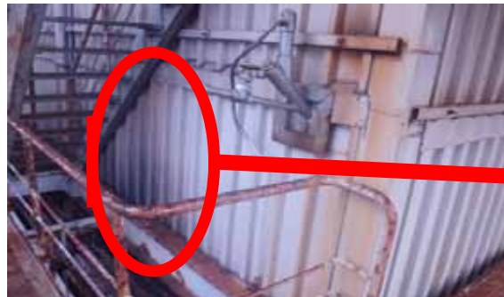
ボイラ内部燃焼排ガス漏れにより ボイラ側面が変色(丸囲み内)
