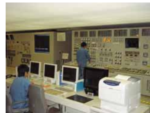
中央操作室での監視状況
