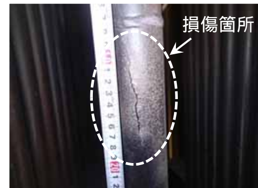
【写真】 再熱器管損傷状況
