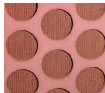
清掃前 (金網が目詰まりしている)
