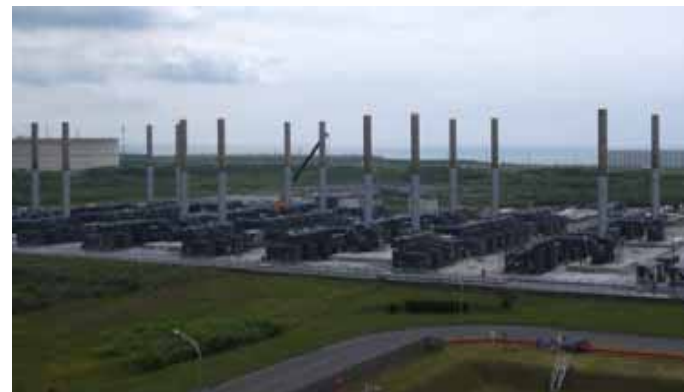
【緊急設置電源（苫小牧発電所）】
