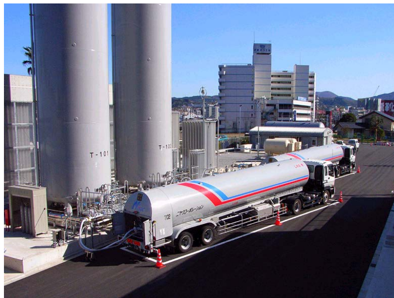
LNGローリー車からの受け入れ
